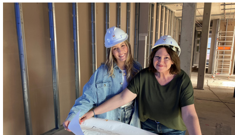
Schirmfrau Laura Papendick macht sich auf der Baustelle ein Bild von den Architekturplänen.
